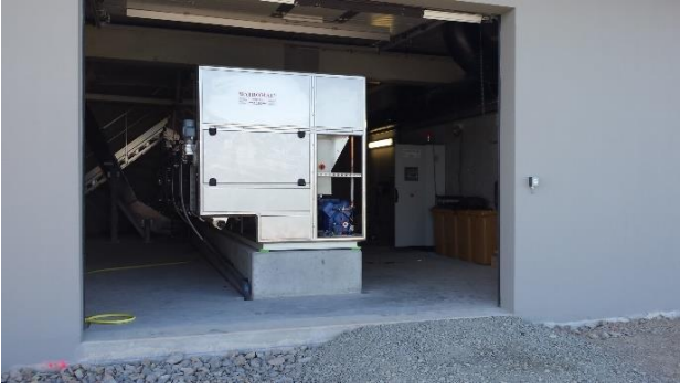
Fransa, Atıksu arıtma tesisi
