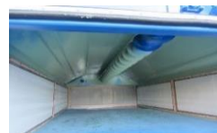
Spremnik za otkotrljanje sa spiralom iznutra
