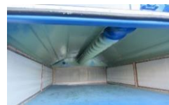
Spremnik za otkotrljanje sa spiralom iznutra
